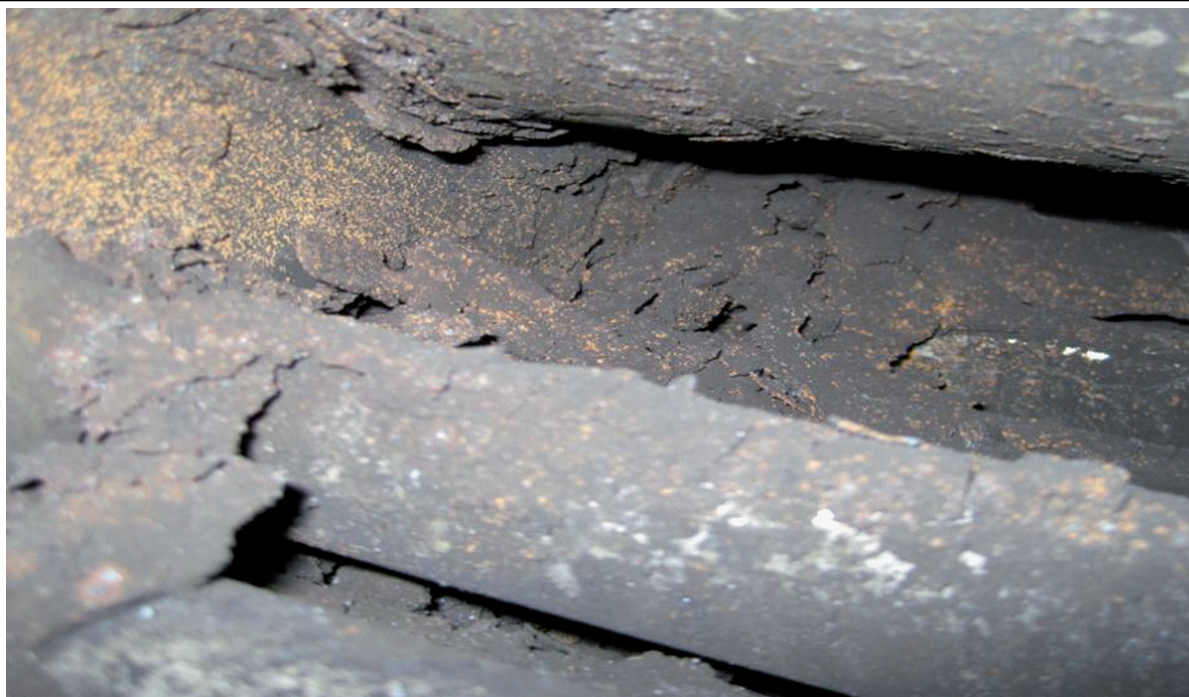
Rys. 19 Osady we wnętrzu kotła spowodowane przez znajdujące się w wodzie grzewczej czynniki powodujące twardość wody
