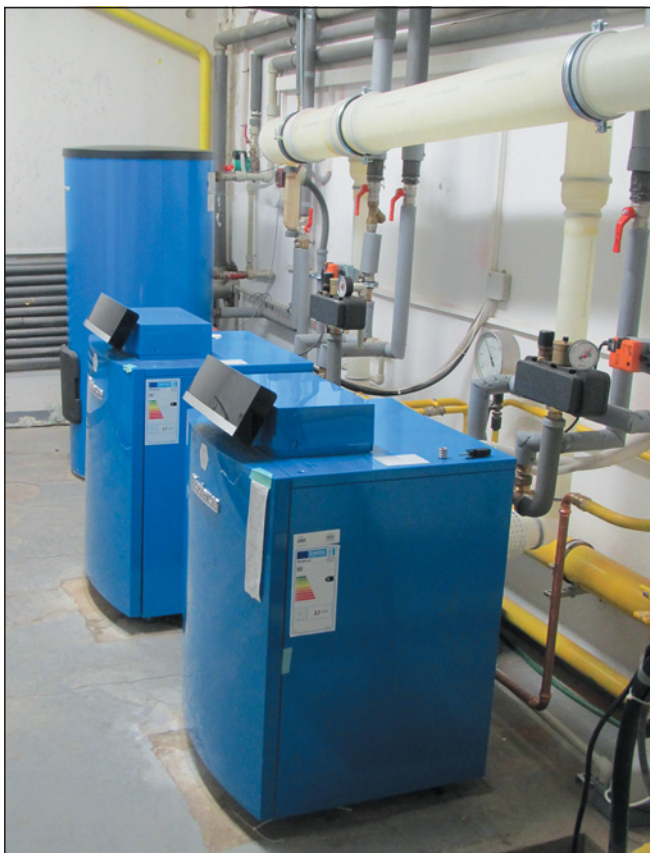
▼ Obr. 1 ● Kotelna bytového domu s kotli Logano plus GB212-40
