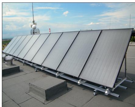
Obr. 2 Solární kolektory Logasol SKN3.0 na ploché střeše
