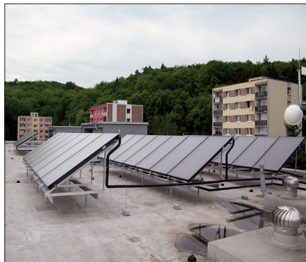
Obr. 6 Solární kolektory na bytovém domě
