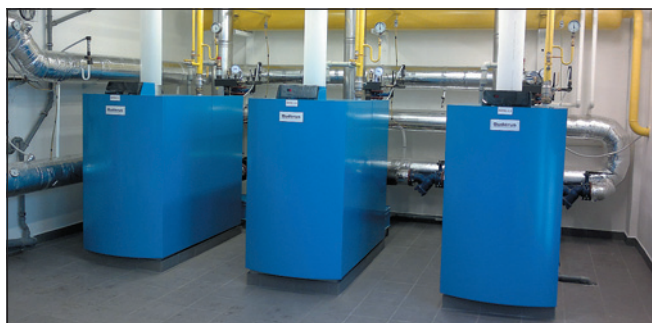
Obr. 3 Kaskáda úsporných stacionárních kondenzačních kotlů
