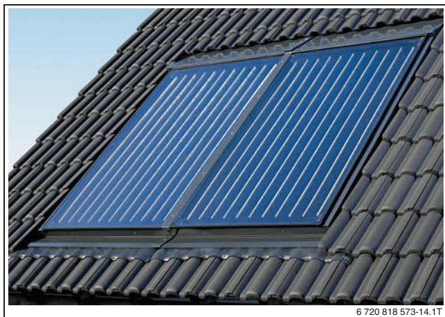
Obr. 166 Pohled na kolektory SKN4.0-s ve střechě
